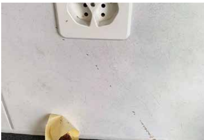
Abb. 1: Eine Pharaoameisenstrasse kommt aus einer Steckdose raus und führt zum Leberköder (Befallsanalyse). Vermutlich befindet sich ein Nest in einem Mauerhohlraum in der Nähe
